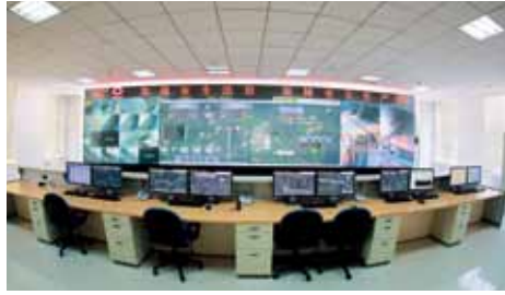
无人值守水泥生产线中控室
